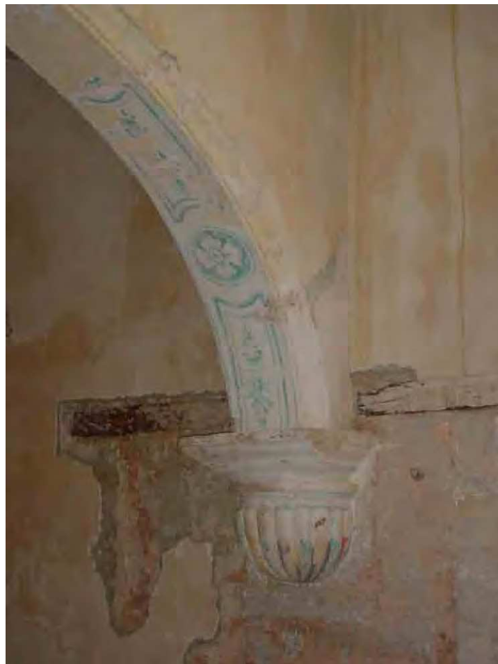
FIG. 6. Vista del arranque del arco oeste donde se aprecia el vano tapiado y el dintel cortado
