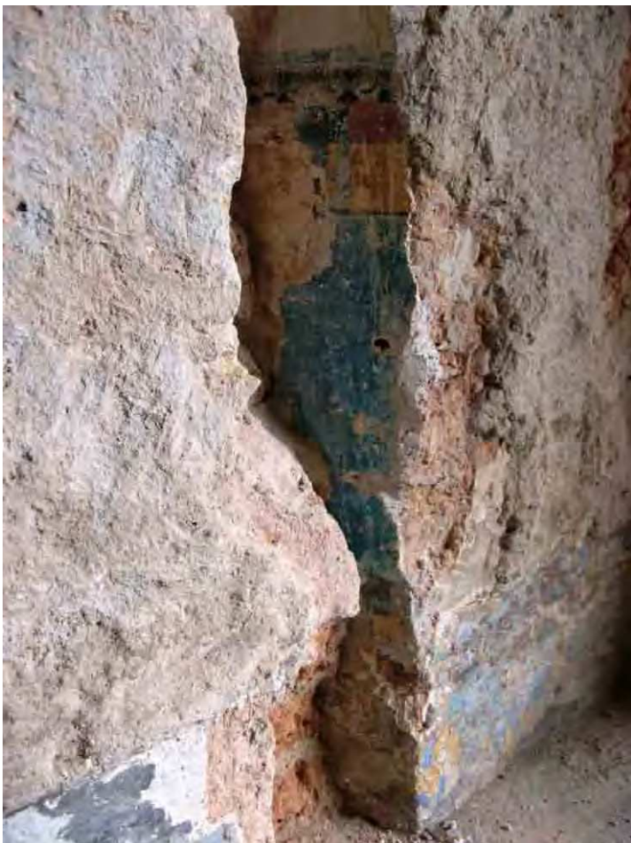
FIG. 9. Pinturas Murales en el vano tapiado por Obras Públicas del muro 11
